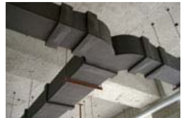
En total se han instalado más de 2,500 m 3 de planchas y coquillas Armaflex
